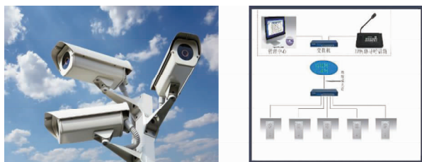
图 4 工地现场监控系统
