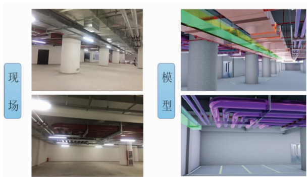
图 22 现场机电样板间
